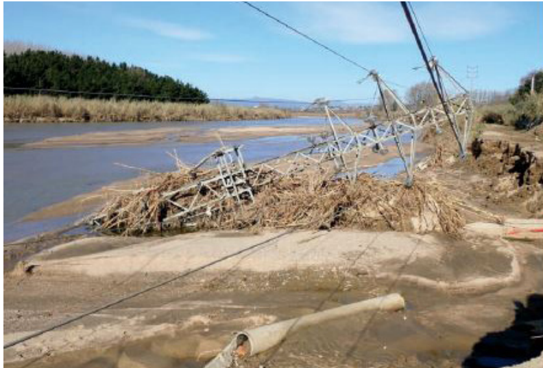
AFECTACIÓ D'UNA TORRE D'ALTA TENSIO A LA PLANERA, MARGE ESQUERRE DEL TORDERA
